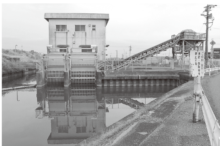
服岡排水機場
