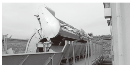
服岡排水機場のゴミを上げる機械(除塵機)
