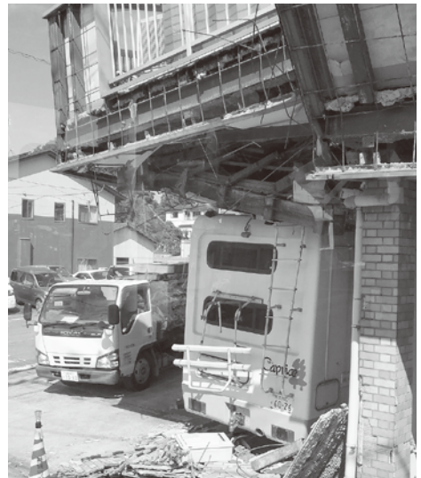
1階がくずれ、キャンピングカーで かろうじて支えられている
