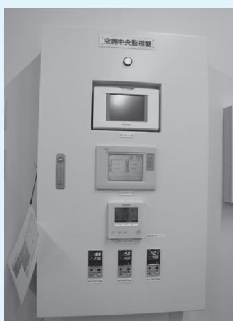
事務室にある制御盤
