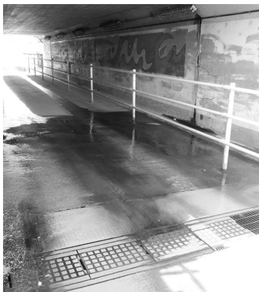
悪臭がする地下道
