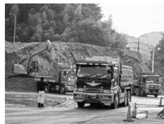
災害で発生した土砂の集積所
