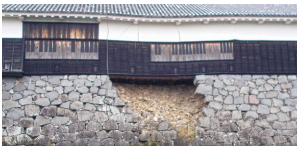
崩落した状態の石垣
