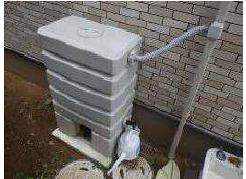
（雨水貯留タンク）
