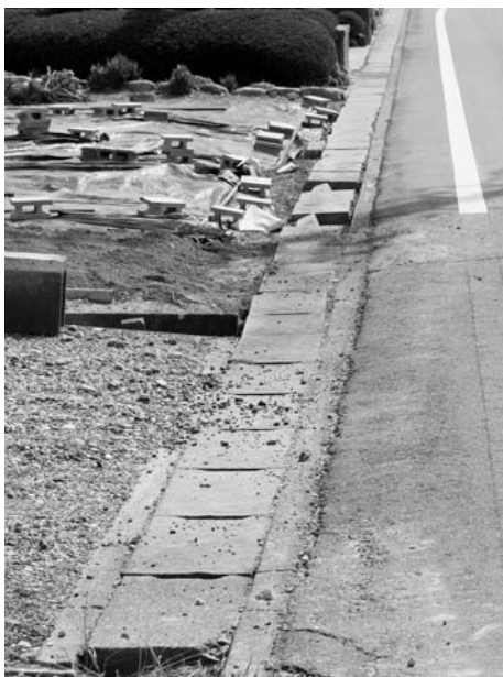
ふたが落ちている側溝
