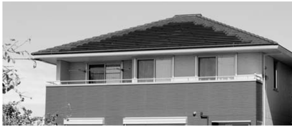
太陽光パネル
